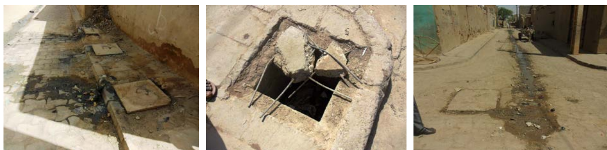
Insuffisance d'entretien du système
