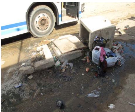
Photo 6 : Regard ébréché bouché par des déchets solides et réseau qui déborde dans la rue à Rufisque (Sénégal).
