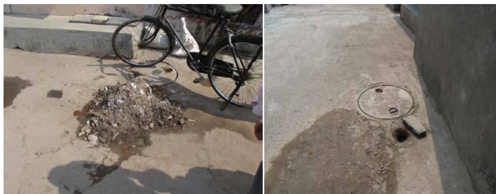
Photos 5 et 5 : boues de regards vidées à même la rue, regard percé pour les eaux pluviales et tuyaux cassés à Ramagundam, Inde
