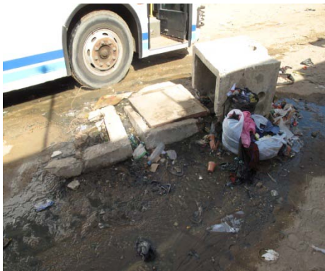
Photo 4 : Regard ébréché bouché par des déchets solides et réseau qui déborde dans la rue à Rufisque (Sénégal).
