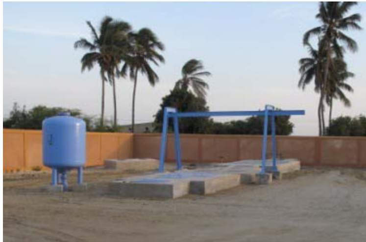
Photo 1 : Station de relèvement à Saint-Louis, Sénégal (de grande capacité car accueille également les effluents d'un réseau conventionnel).
