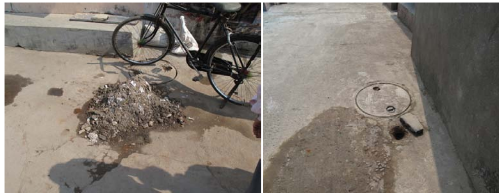
Photos 3 et 5 : boues de regards vidées à même la rue, regard percé pour les eaux pluviales et tuyaux cassés à Ramagundam, Inde
