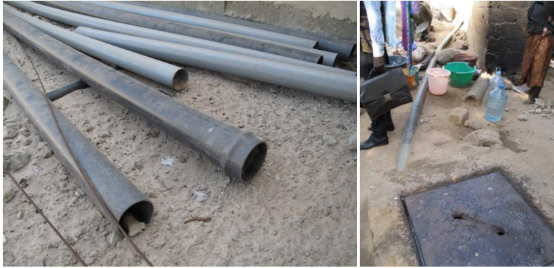
A gauche : tuyaux de PVC haute pression utilisés pour les collecteurs principaux à Cayar. A droite canalisations posées à même le sol rocheux à Baraka, Dakar.
